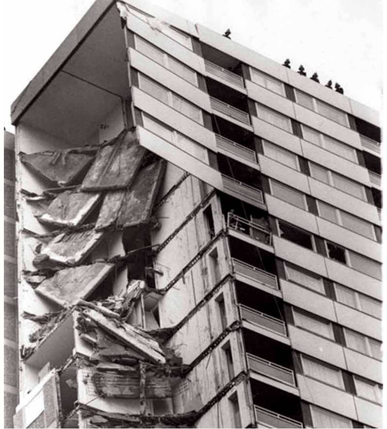
حادثة انهيار جزء من مبنى «رونان بوانت» بسبب مشكل إنشائي
